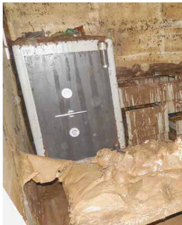
Im Tresorraum hatte sich eine 30 Zentimeter dicke Schlammschicht gebildet.
